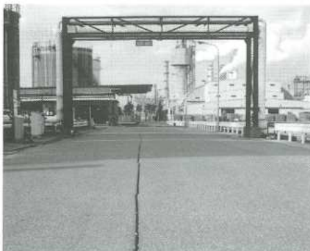
震災で亀裂が生じた信越酢酸ビニルの場内道路
