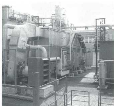
磯部工場のコージェネレーション設備
