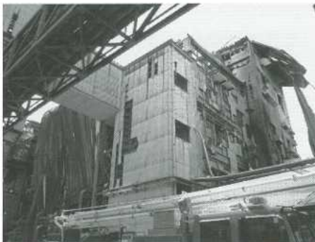
直江津工場セルロース製造設備の事故現場
